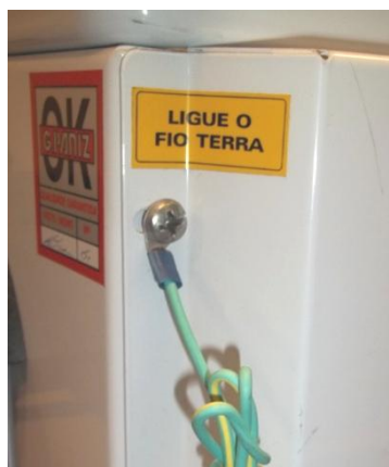
Figura 10 - Ausência da marcação com símbolo de aterramento conforme Norma.
