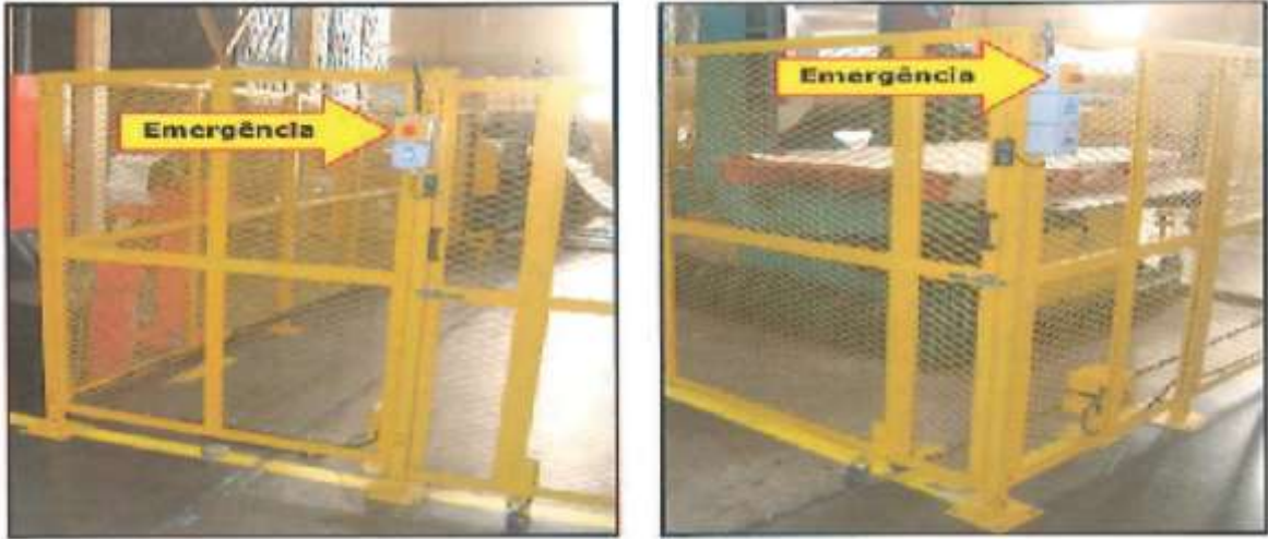
Figura 10 – Botões de parada de emergência do isolamento físico
