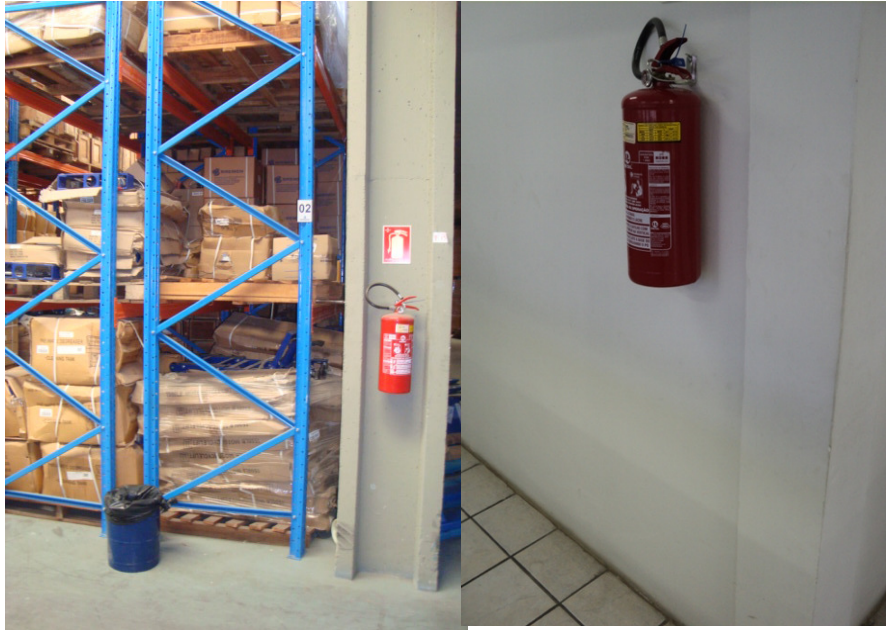
Figura 10: Extintores sem sinalização horizontal
