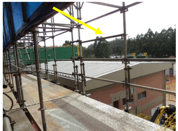
Figura 58: Ausência Guarda corpo e Rodapé
