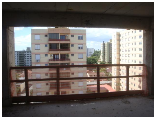
Figura 3 - Laje com proteção de periferia em balanço com montante de madeira.
