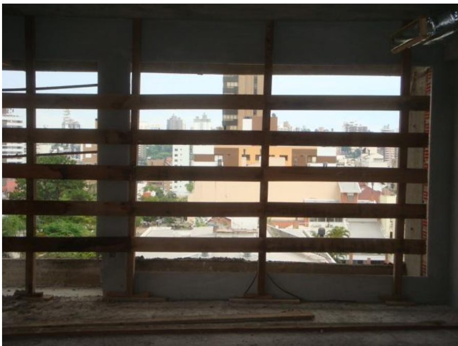
Figura 5 - Janela com proteção de periferia bi-apoiada.
