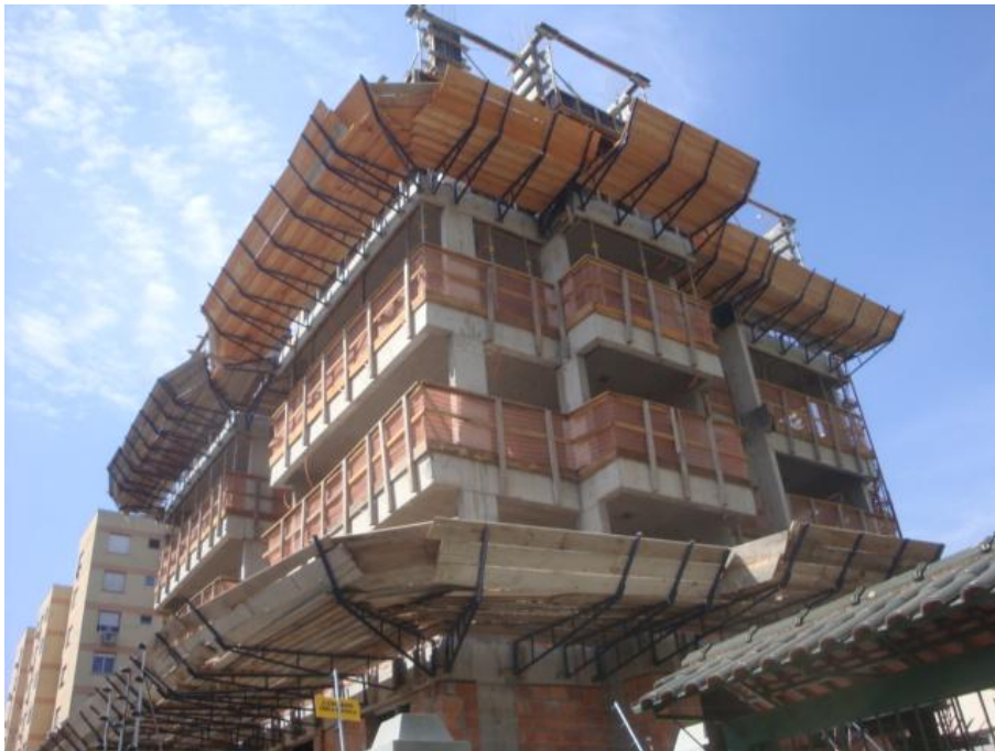
Figura 1 - Exemplo de edifício com proteção de periferia.
