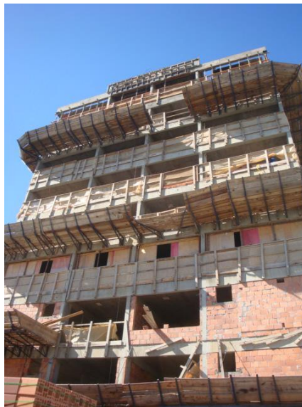
Figura 8 - Edifício com a proteção de periferia não retirada durante a execução da alvenaria.
