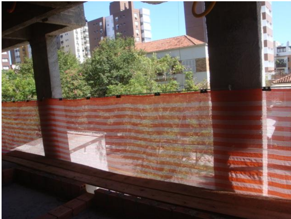
Figura 6 - Peitoril de periferia com cabo de aço.
