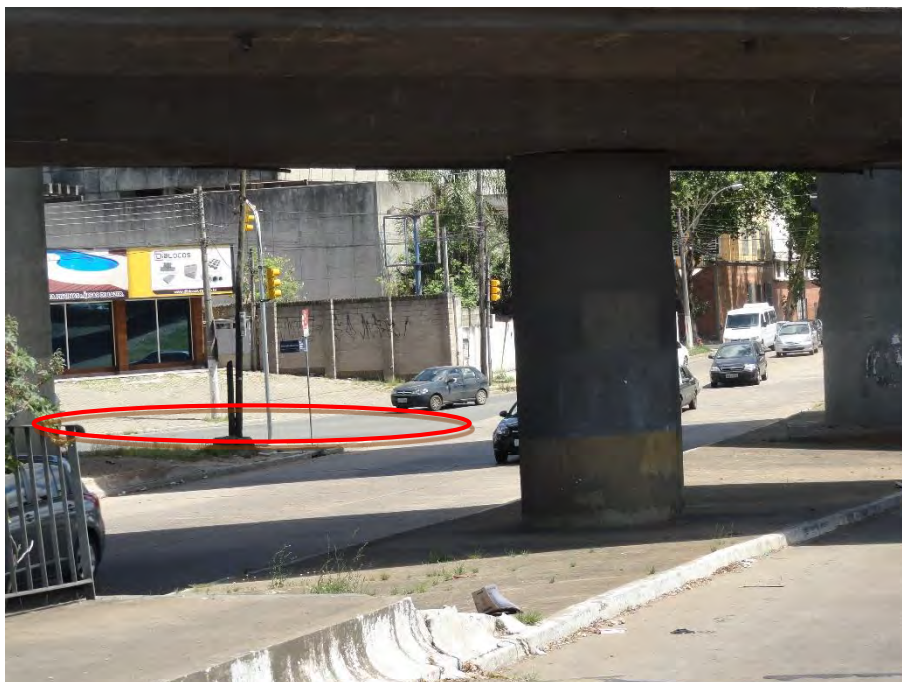
Foto 35: Área onde está a maior concentração dos pontos de alagamento registrados pela EPTC no ano de 2012, no destaque área deprimida, característica das áreas rebaixadas alagáveis. Cruzamento das avenidas Voluntários da Pátria e Sertório, bairro Marcílio Dias. Dezembro de 2013.
