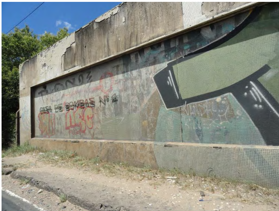
Foto 39: Casa de Bombas nº 04, localizada junto à avenida Castelo Branco, bairro Marcílio Dias. Dezembro de 2013.
