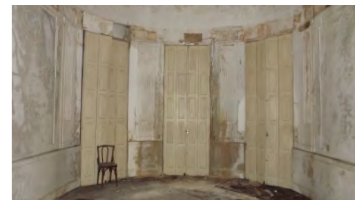
FIG 67: Sala do Piano, ou Salão, projetada para a permanência da família. Corresponde à fachada principal (Norte) e a distribuição das aberturas garante sua monumentalidade. Os estuques originais estão danifica- dos, mas alguns apresentam possibilidade de restauro ou reprodução com referência. FONTE: Autora.
