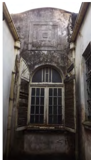
FIG 57: Abertura do vestíbulo para o poço de luz. O ecletismo vem percebido na platibanda geométrica contrastante com o resto.
