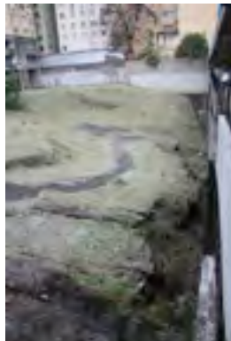
Desnível no edifício garagem
