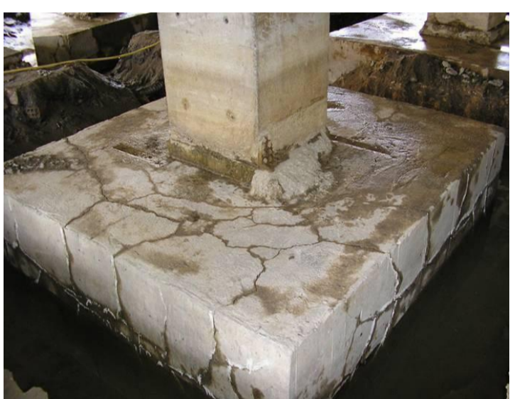
Fig.3: Bloco de Fundação com RAA
