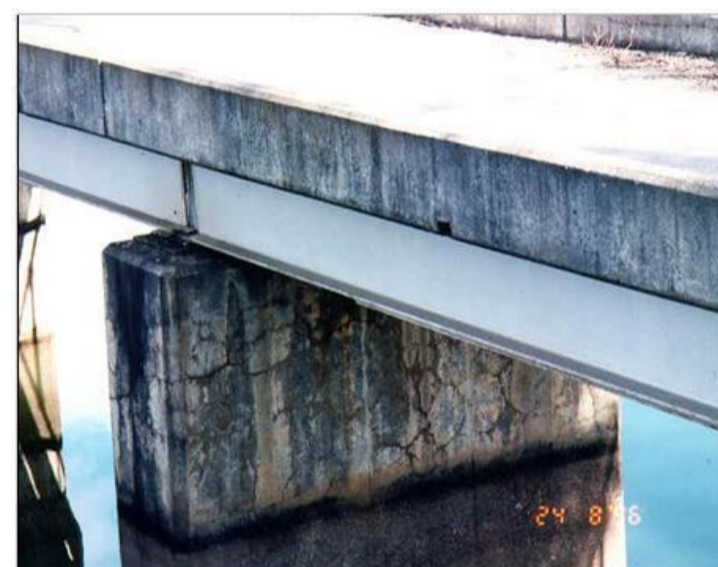
Fig. 4: Ponte sendo danificada pela RAA
