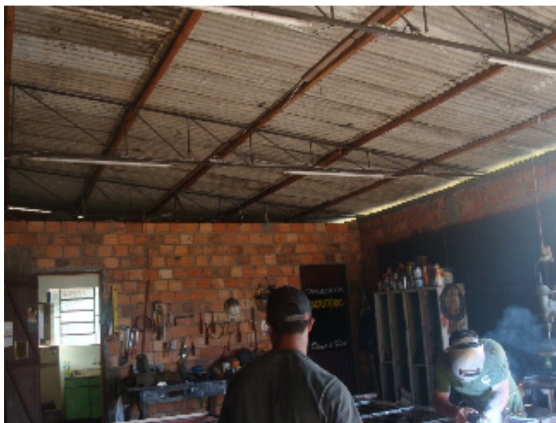
Figura 4.6 – Ausência de isolamento térmico e sistemas de ventilação forçada
