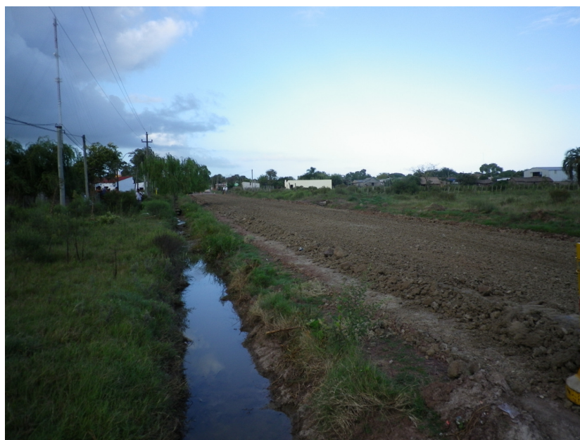
Figura 4.20. Condição de uma valeta no segundo trecho experimental
