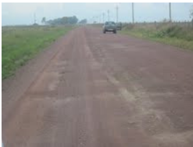
Figura 4.13. Desgaste superficial da camada de material residual de riolito no primeiro trecho experimental
