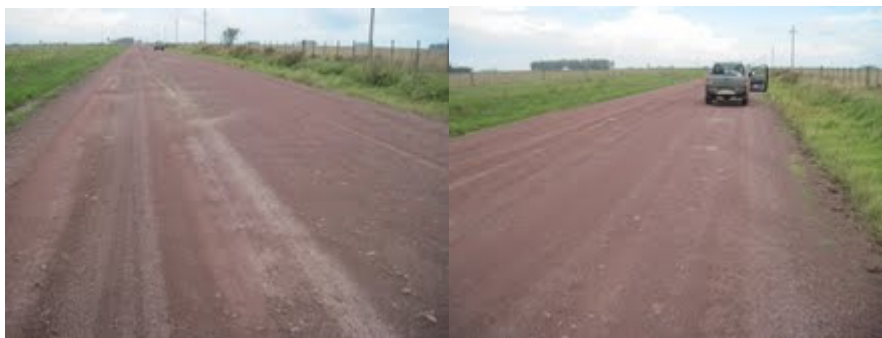
Figura 4.14. Condição superficial do primeiro trecho experimental com 5 anos de serviço (abril de 2013)
