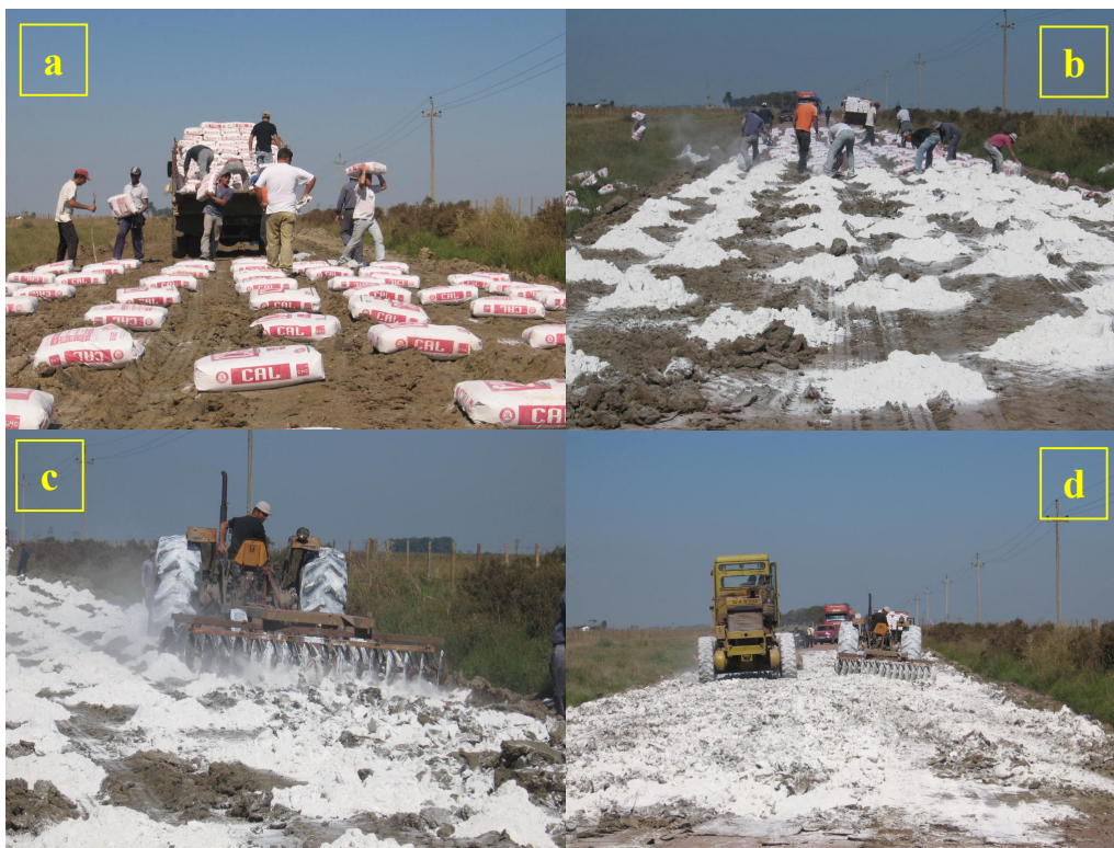
Figura 4.6. Operações de distribuição da cal e mistura ao solo. a) Colocação dos sacos de cal; b) Rasgado dos sacos de cal; c) Mistura da cal com o solo; d) Espalhamento da mistura do solo com a cal
