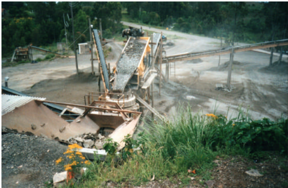
Figura 10 Foto Visão Geral da Instalação de Britagem
