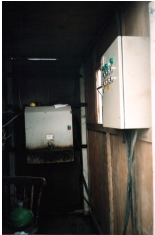
Figura 16 Foto Interior de Quadro de Comando
