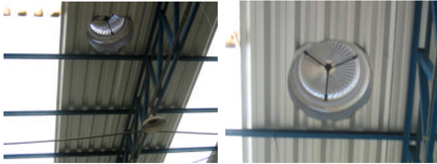
Figura 45: Exaustor eólico na fábrica em estudo
