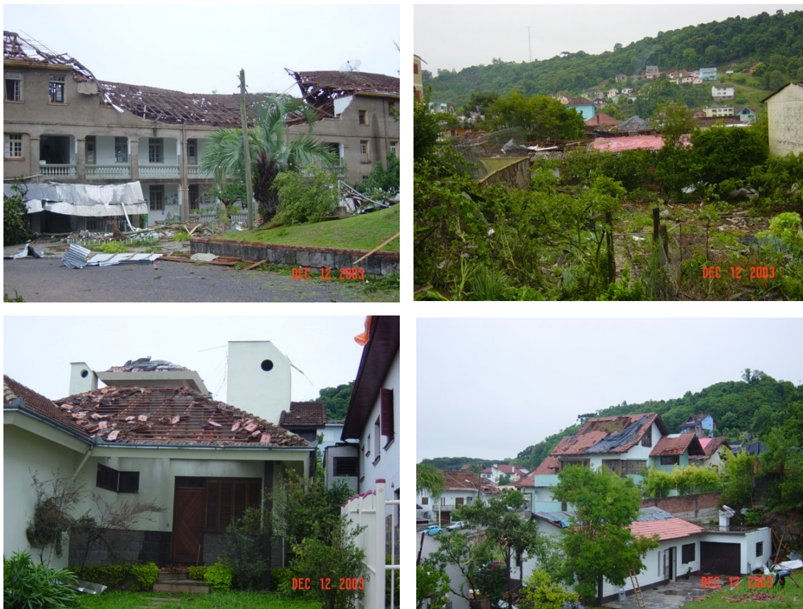
FIGURA 7.25 - Fotos da destruição causada pela passagem de tornado sobre a cidade de Antônio Prado em 11 de dezembro de 2003.
