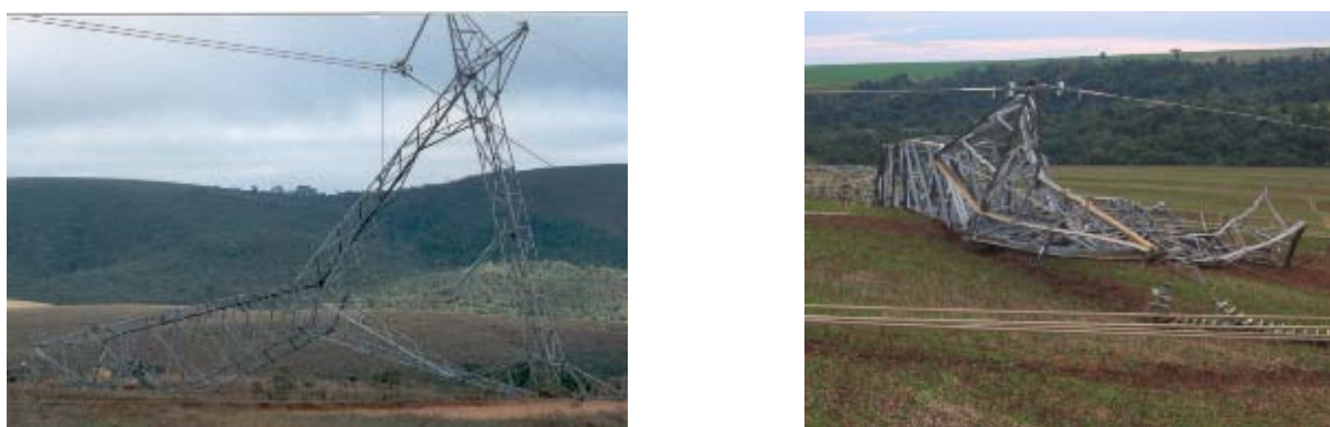
Figura 1.1: Exemplos típicos de colapso de torres de linhas de transmissão.
