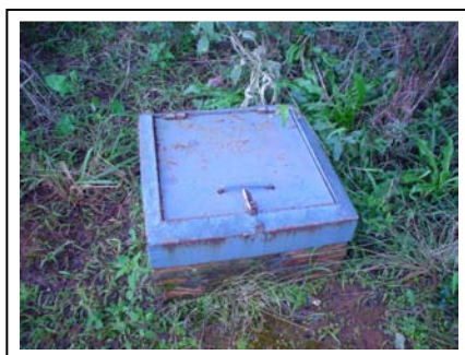
Figura 29: Poço de Monitoramento – Ezo (jul/2005)
