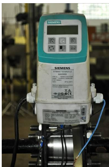
Figura 4.4: Medidor de vazão.
