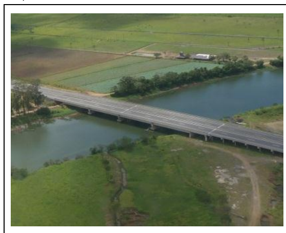
Figura 51. Detalhe da elevada no trecho sobre o canal do rio Maquiné, BR 101/RS.
