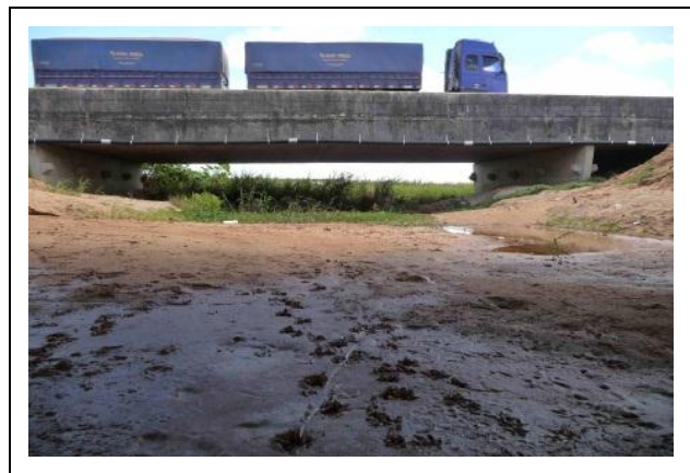
Figura 55. Pontilhão Várzea 1, BR 392/RS, com laterais secas para passagem de fauna. (Coord. Geogr. 52°19'28\"/>
