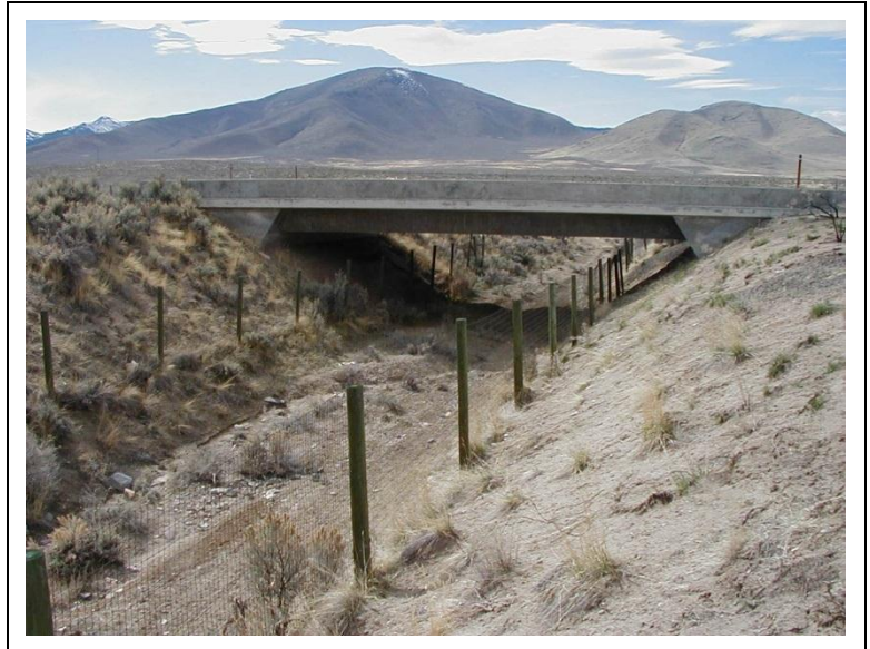
Figura 25. Passagem inferior em Sierra County, Califórnia. Foto: Brian Ehler, Calif. DF&G (CALTRANS 2009).
