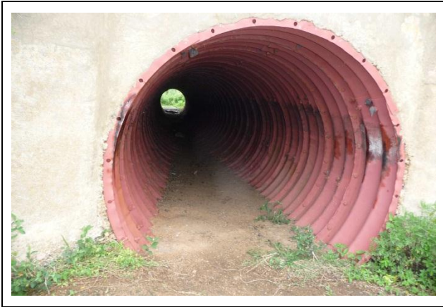
Figura 22. Passagem de fauna construída com bueiro tubular corrugado na BR 471/RS – Estação Ecológica do Taim.
