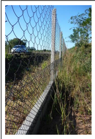
Figura 94. Cerca com base em concreto e tela em malhas progressivas. BR 101/RS.
