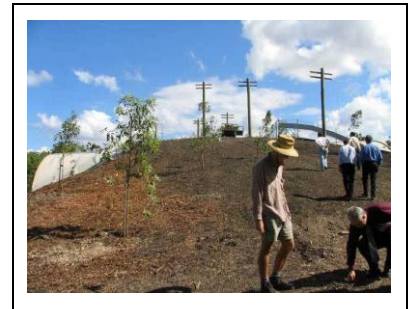
Figura 36. Implantação da vegetação na passagem superior. Ao fundo, postes com poleiros para aves (VEAGE & JONES 2007).
