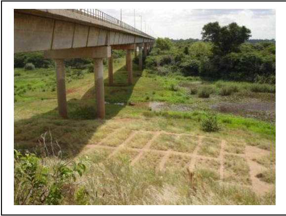
Figura 52. Ponte São Borja (Brasil) – Santo Tomé (Argentina), com amplos vãos secos junto às cabeceiras. (Coord. Geogr. 56°00'40\"/>
