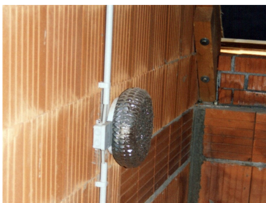
Figura 91: instalações elétricas aparentes
