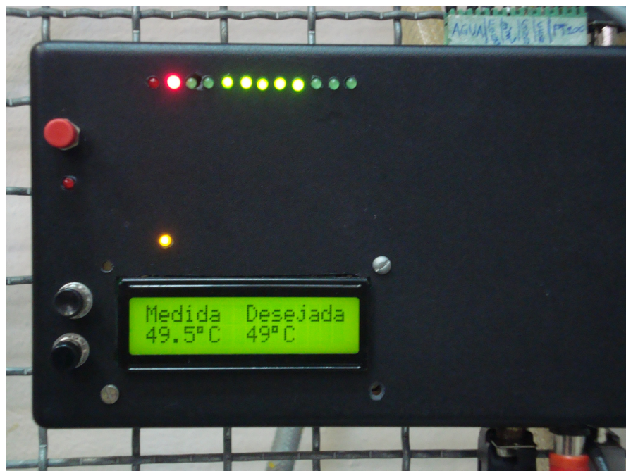
Figura 4.23: Fotografia do controlador em operação
