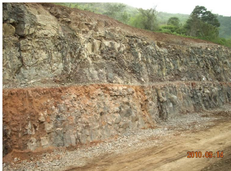
Figura 3.8: Aspecto do corte no 61+200 em que a banqueteta de corte foi feita coincidente com a transição de derrames (e presença de arenito brando) (Foto: L. A. Bressani).
