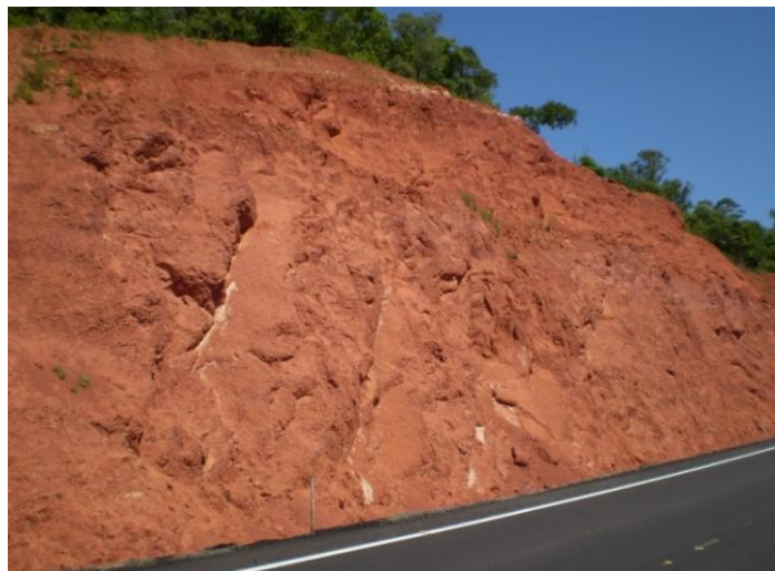
Figura 3.12: erosão em siltitos com presença de materiais expansivos no segmento “Planície”.
