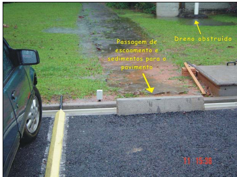
Figura 3.5. Foto dos drenos obstruídos com passagem de água e sedimentos para o pavimento.
