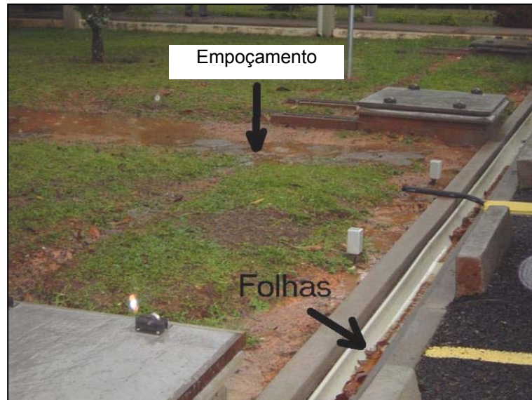
Figura 4.1. Acúmulo de folha nas calhas coletoras do escoamento superficial.
