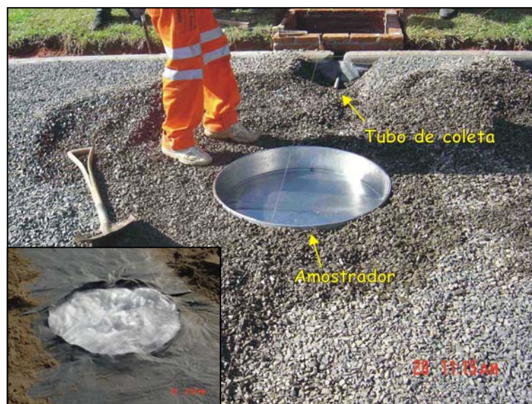
Figura 3.37. Assentamento de coletor de água para análise qualitativa, e a cobertura com lã-de-vidro no detalhe.
