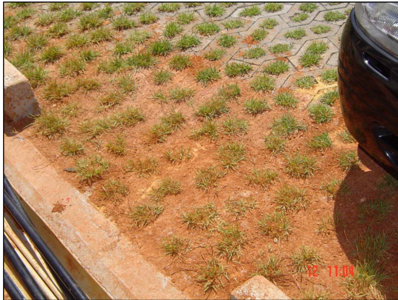
Figura 4.2. Acúmulo de sedimentos nos blocos devido a obra próxima.
