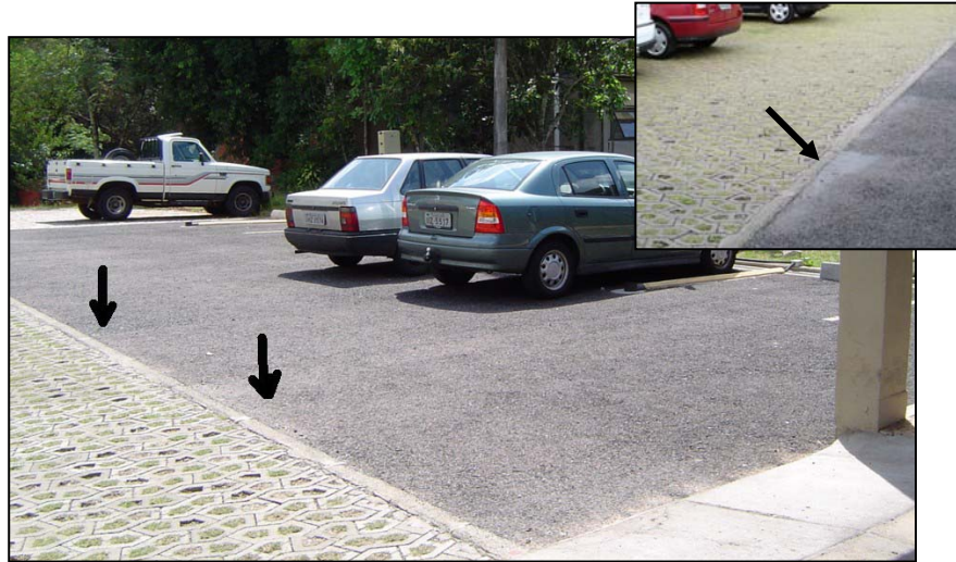
Figura 4.3. Depressões no revestimento asfáltico.
