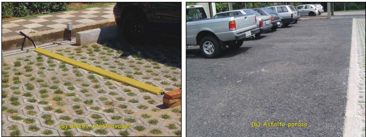
Figura 3.16. (a) Revestimento do pavimento com blocos intertravados de concreto, preenchidos com tufos de grama; (b) Revestimento do pavimento com asfalto pré-misturado a frio de granulometria aberta.
