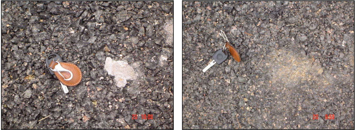
Figura 4.5. Acúmulo de sujeira no pavimento.
