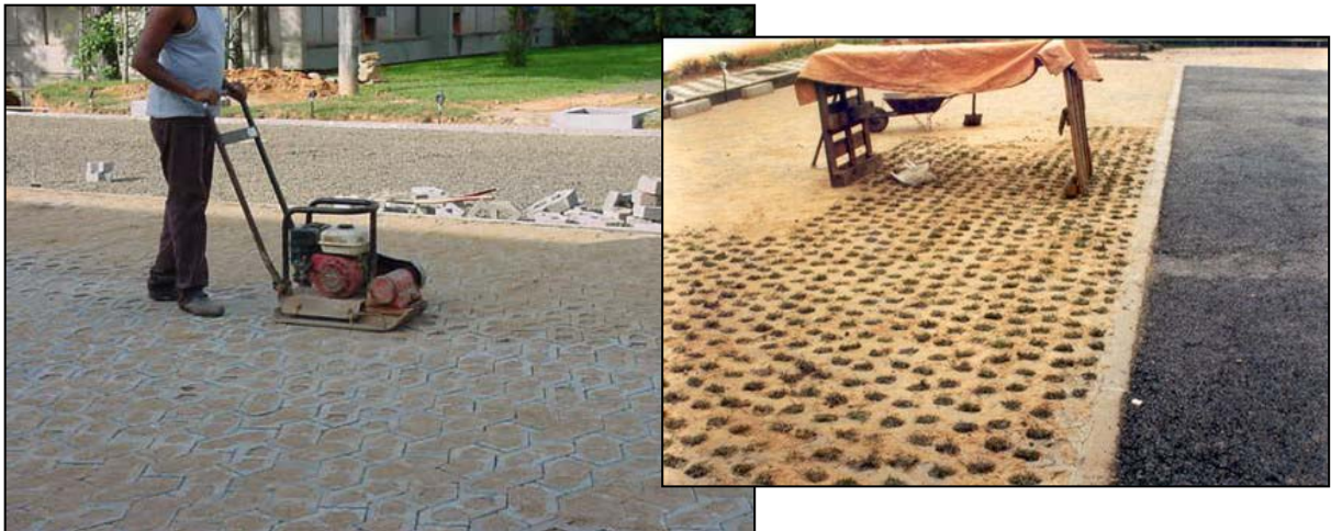
Figura 3.33. Nivelamento dos blocos intertravados, e colocação de tufos de grama nas aberturas dos blocos.
