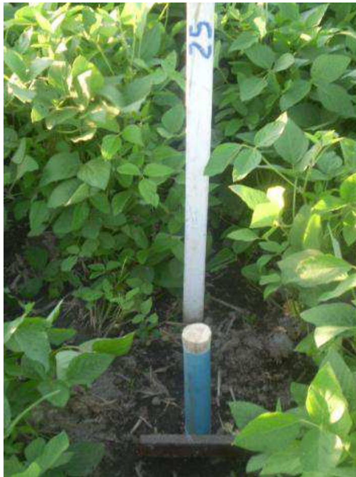
Figura 4.14. Poço de Observação nº 25 em PVC 50 mm com travessa e tampão.
