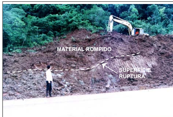
Foto 4.3: Superfície de ruptura do talude
