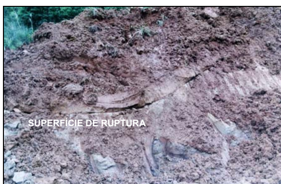
Foto 4.4: Detalhe da superfície de ruptura do talude
