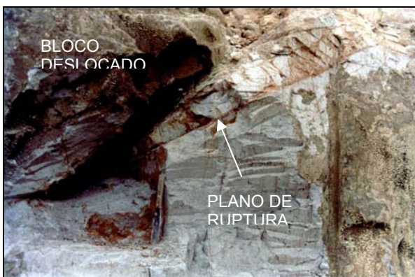
Foto 6.3: Detalhe da Foto 6.2
