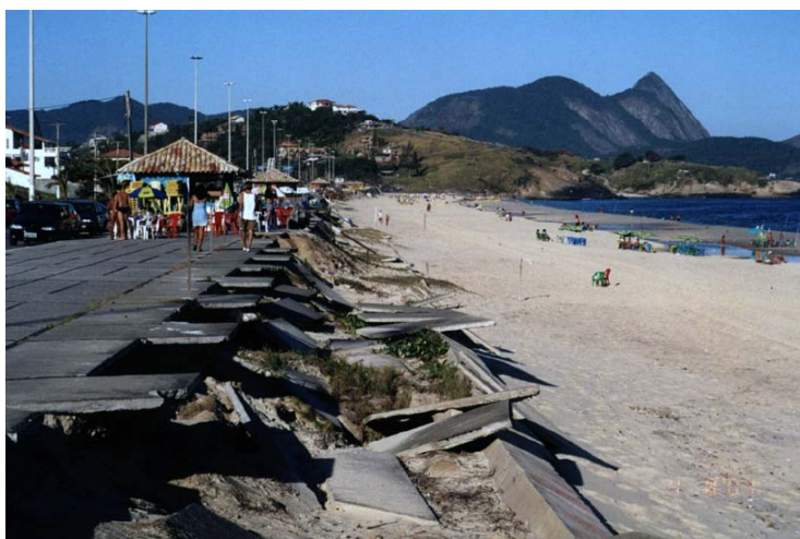
Figuras 8: Destruição de muro na praia de Piratininga em Niterói após ressaca de 2001 (MUEHE, 2011)
