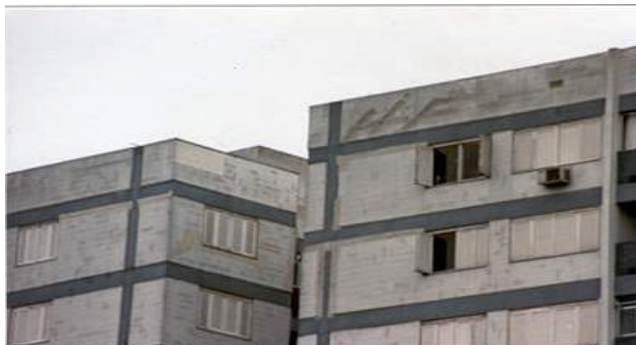
Figura 2: manifestações patológicas proveniente de umidade em blocos de concreto sem revestimento (Cortesia: CIENTEC)
