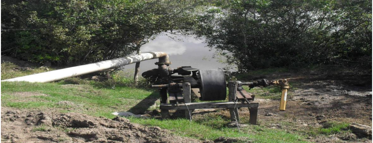
Bomba de sucção utilizada na irrigação – Estância “A”. Fotografia: Valeriano Alan Jardim de Moraes (autor).
