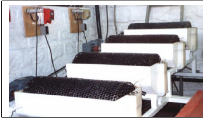
Figura 4.2: Unidade piloto de contadores biológicos rotatórios
