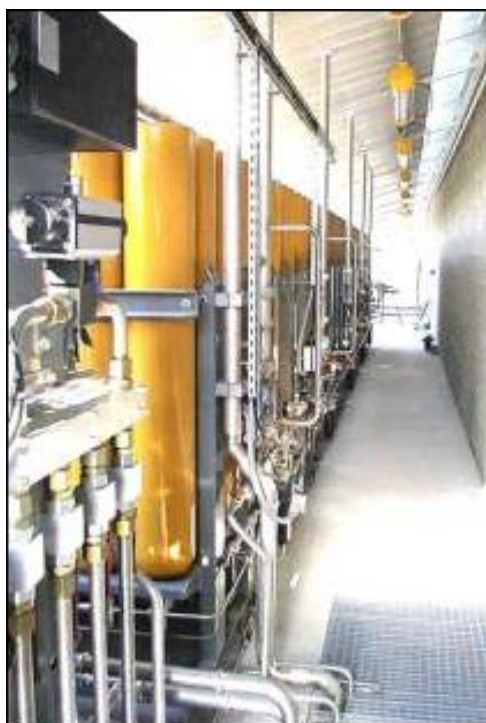
Figura 14 Armazenamento de alta pressão Fonte: RATP, 2001
