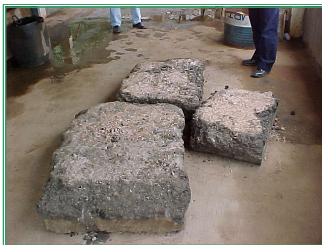
Figura 4.13 - Placas Removidas nos km 98, km 112+080 e km 112+170
