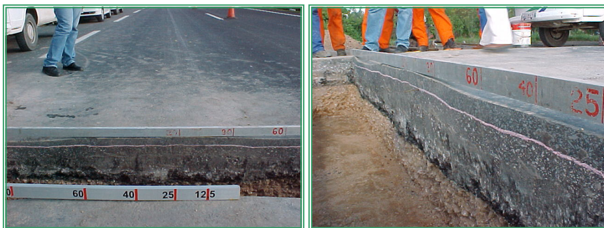
Figura 4.10 Trincheira Escavada no km 109 Mostrando o Comportamento do Afundamento de Trilha de Roda nas Camadas do Pavimento
