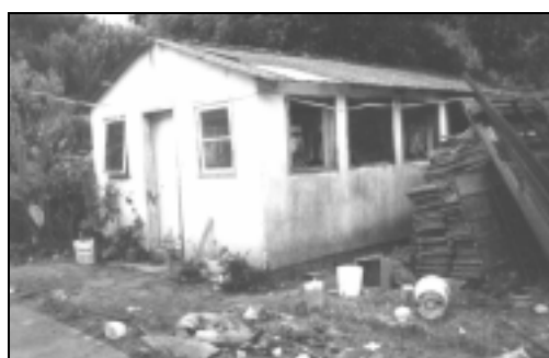
Figura 26: Instituição E1 – entulho e aspecto de abandono em área do pátio com potencial de utilização.
