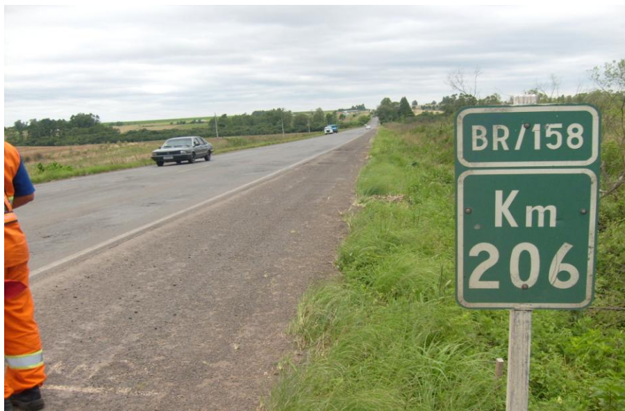
Figura 21: vista geral do segmento monitorado da BR-158 – Km 206+200 ao 206+400, Município de Cruz Alta/RS – Condição inicial
