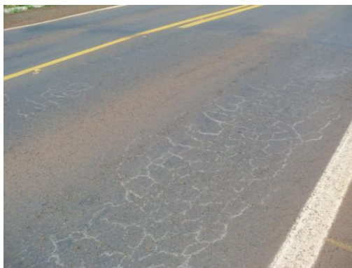
Figura 02: exemplo de trincamento interligado tipo “couro-de-jacaré” com bombeamento de finos. BR-285/RS km 464.
