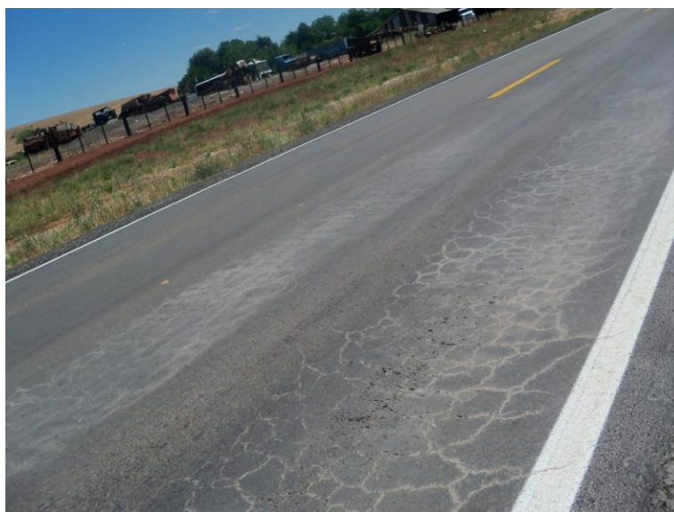
Figura 07: exemplo de local com bombeamento de finos através de fendas para a superfície do revestimento asfáltico. BR-158/RS (município de Cruz Alta)
