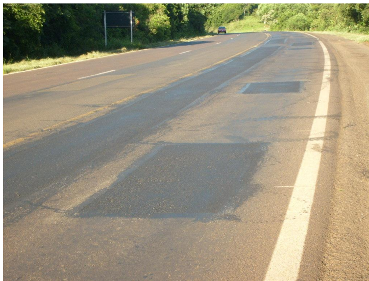
Figura 05: exemplos de remendos executados em trecho da BR-285/RS (município de Entre-Ijuís)
