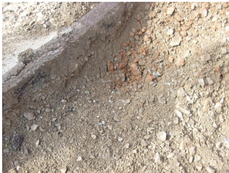
Figura 08: exemplo de um local com contaminação da camada de base de brita graduada com material argiloso proveniente do subleito. BR-285/RS (município de Entre-Ijuís)
