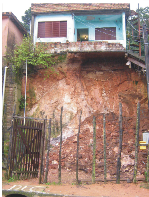
Figura 16: Escorregamento instabilizando a estrutura da moradia sobre a área de corte. Rua Dallas, bairro Cascata.
