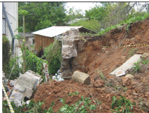
Figura 18: Registro de escorregamento. Rua Erechim.
