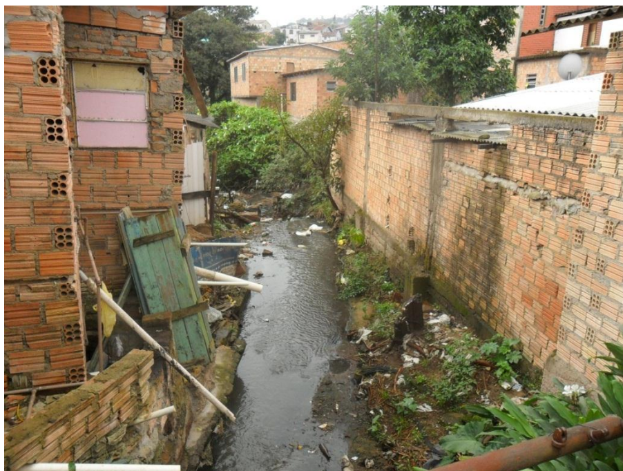
Fotografia 27 – Despejo das águas servidas no arroio - sub-bacia do arroio Moinho - Porto Alegre/RS. Fonte: Rafael Lopez (27.05.2011).
