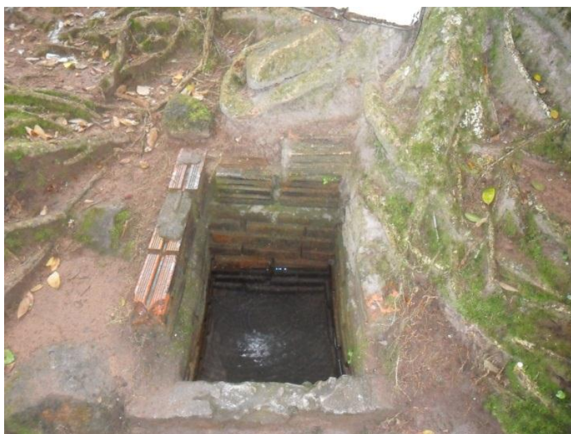
Fotografia 23 – Poço improvisado para consumo de água – Morro Pelado - sub-bacia do arroio Moinho - Porto Alegre/RS.
