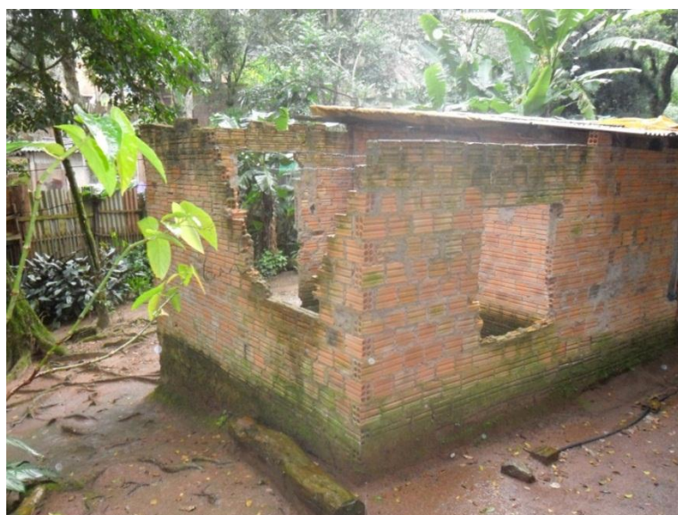
Fotografia 25 – Residência parcialmente destruída pela queda de árvores na UP 4 – Morro Pelado - sub-bacia do arroio Moinho - Porto Alegre/RS. Fonte: Rafael Lopez (27.05.2011).
