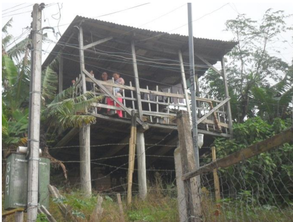
Fotografia 14 – Encosta superior da UP 5 – Baixo padrão construtivo das moradias – Morro da Polícia - sub-bacia do arroio Moinho - Porto Alegre/RS. Fonte: Rafael Lopez (27.05.2011).
