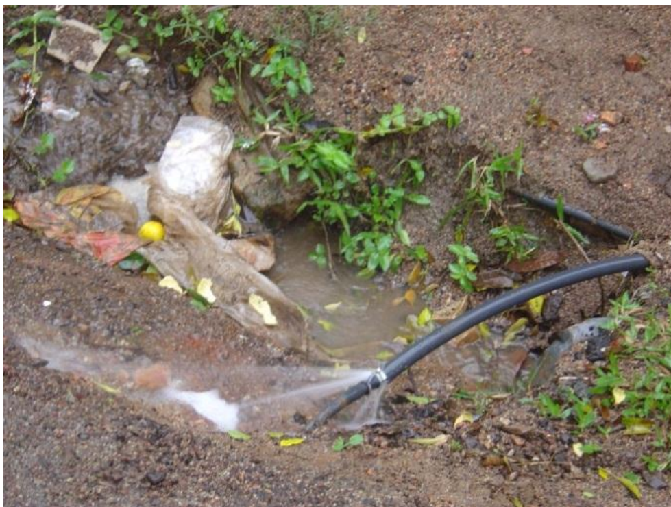
Fotografia 18 – Encosta superior da UP 5 – Instalações de água – Morro Pelado - sub-bacia do arroio Moinho - Porto Alegre/RS. Fonte: Rafael Lopez (27.05.2011).
