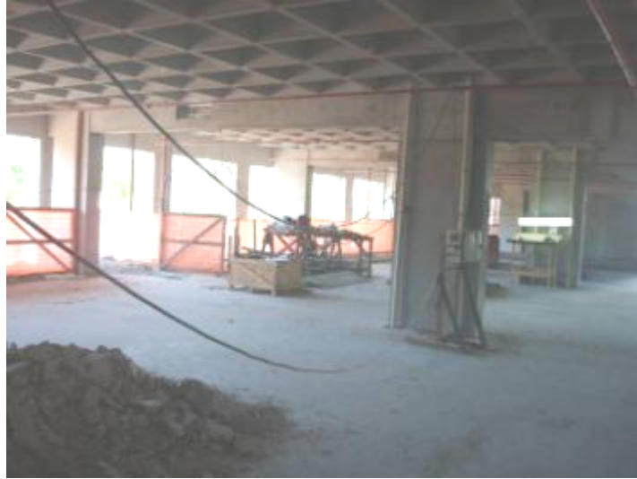
Figura 24 – cabo elétrico suspenso sobre tubulação de incêndio
