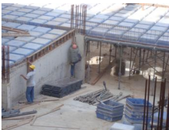
Figura 47 – Carpinteiro em altura inadequada para montagem de fôrma
