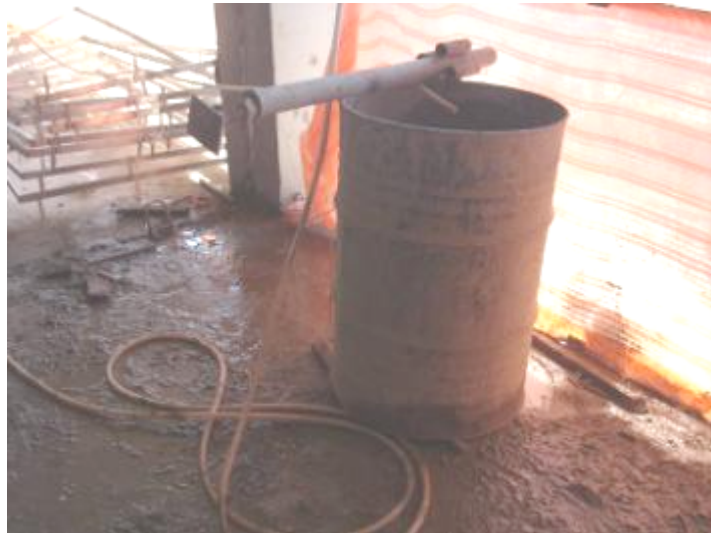
Figura 25 – Reservatório de água provisório
