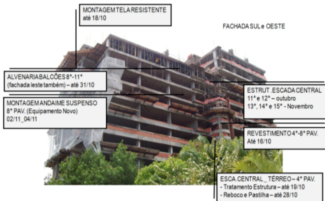
Figura 20 – Estratégia para execução da estrutura e fechamento das fachadas sul e oeste
