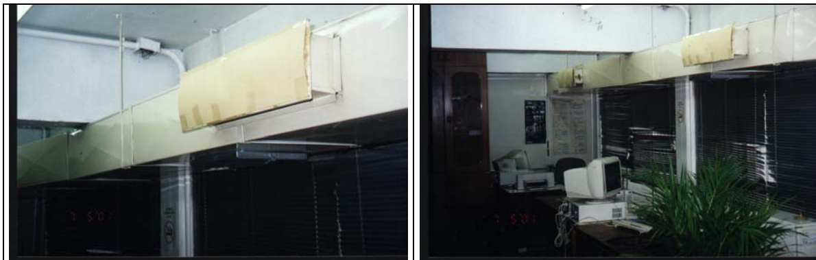
Figura 6 – saídas do duto do ar condicionado central bloqueadas denotam o desconforto
