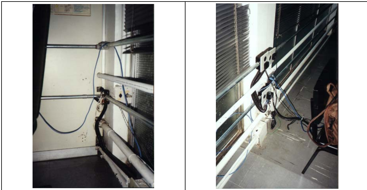
Figura 14 – detalhe das condições dos fios, cabos e tubulações
