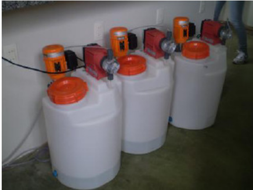
Figura 4.12: Foto dos tanques de produtos químicos.
