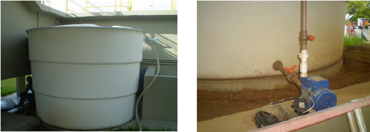
Figura 4.4: Reservatório da água de estudo e bomba de recalque para IPDF.
