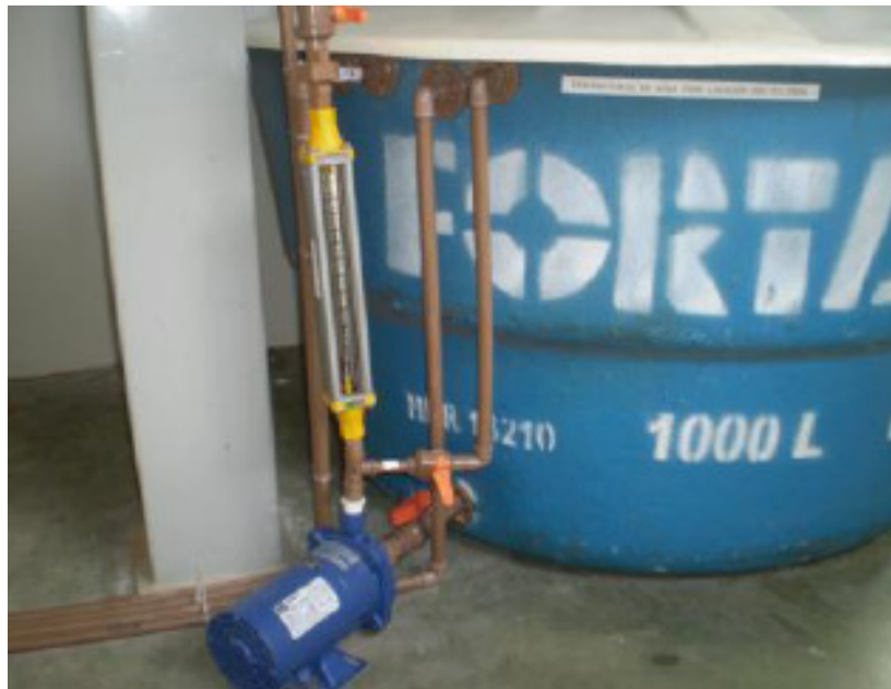
Figura 4.13: Foto do sistema de lavagem dos filtros.
