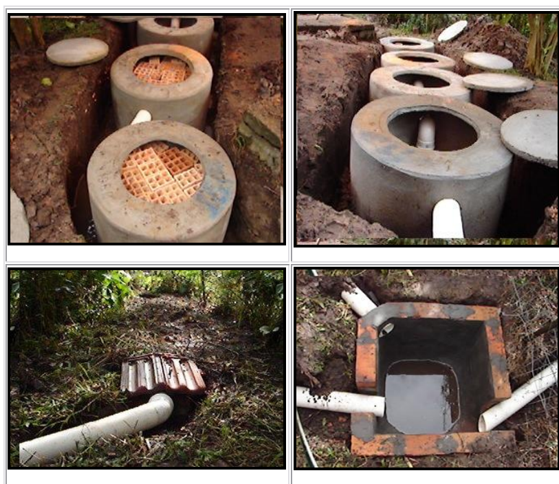
Foto 30 – Sistema de tratamento biológico do esgoto – Sítio Capororoca
