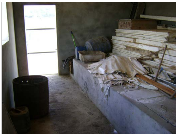
Figura 38. Interior do local de acondicionamento temporário dos resíduos secos provenientes de outras atividades fora do processo industrial.
