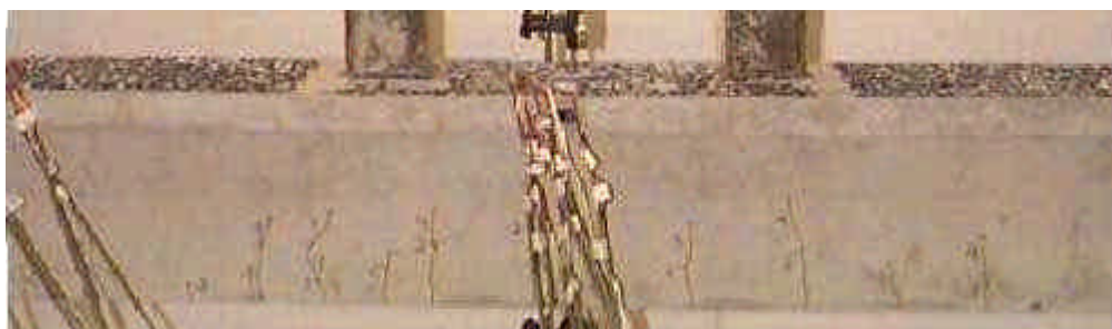
(a) Fissuração na VFC-1 (após a Protensão 1 – F_v = 19,6 kN)
