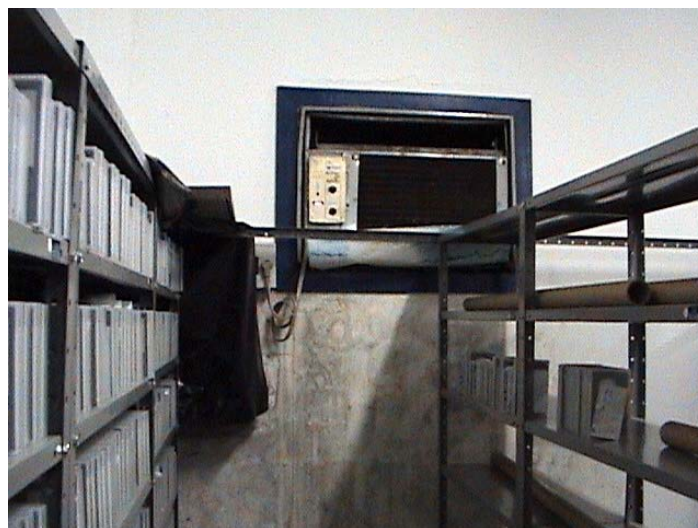
Figura 36 – Sala do Arquivo da TVE: ar condicionado desativado. Fonte: imagem do autor
