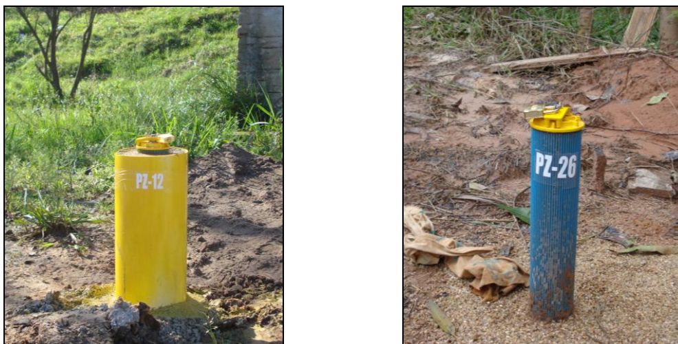
Figura 13 - Foto de dois dos poços de monitoramento instalados na área de estudo, PZ12 com proteção de concreto e PZ26
