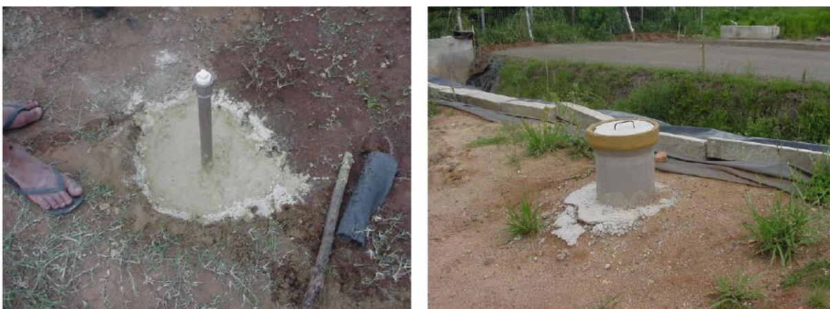
Figura 3.35: Piezômetro P1, com a proteção, para monitoramento da profundidade do lençol freático instalado no local desta pesquisa
