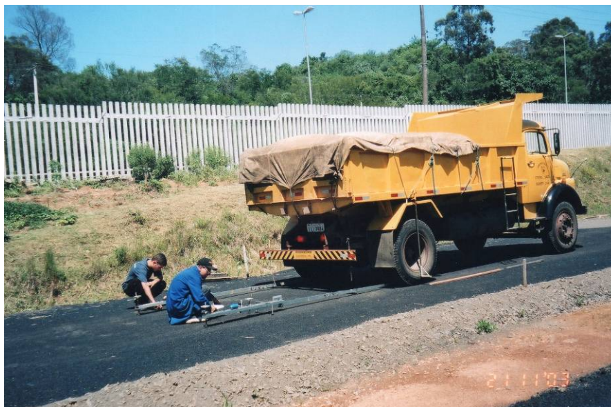
Figura 3.24: Avaliação da deformabilidade elástica com a viga Benkelmann no topo da camada de base nas pistas desta pesquisa
