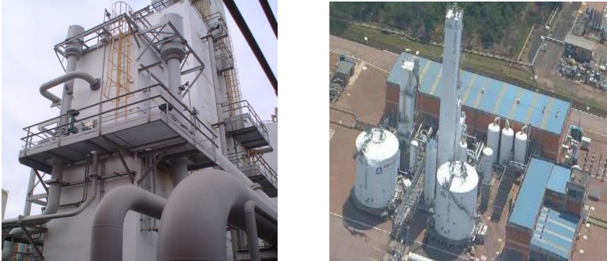
Figura 17 – Fotos de uma Planta Criogênica de gases Industriais Fonte: Arquivos do autor
