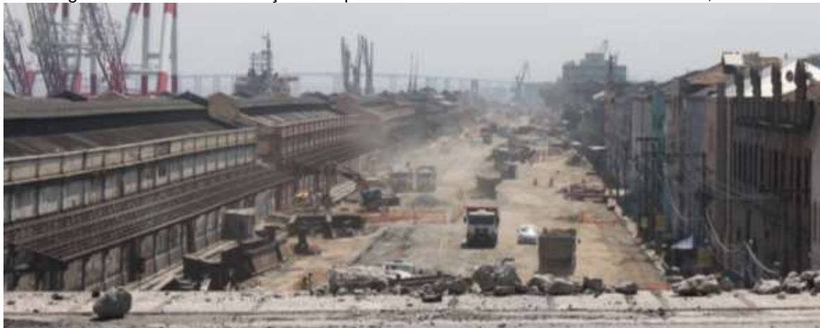
Figura 43 - Obras de remoção e limpeza dos entulhos do Elevado da Perimetral, em 2013
