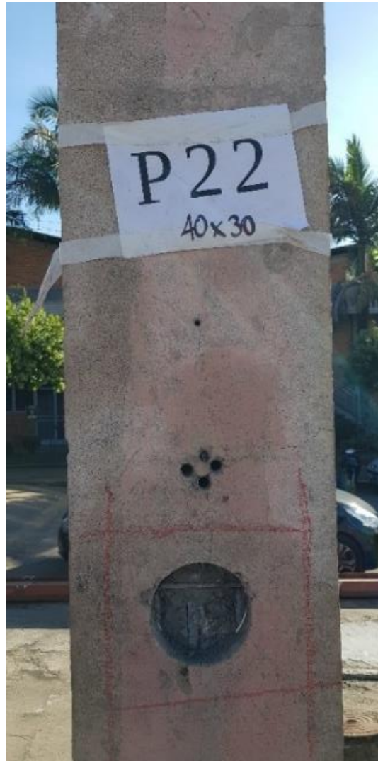
Figura 58 - Pó de concreto já extraído P22
