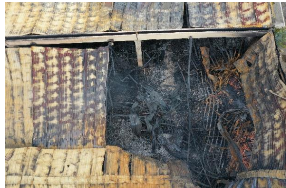
Figura 37 - Telhado desabado na região frontal
