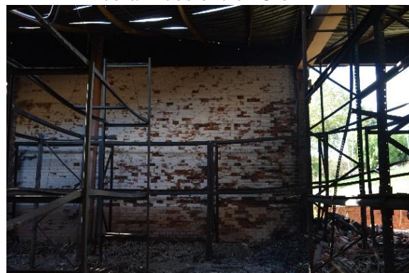
Figura 39 - Deslocamento de blocos cerâmicos entre P3 e P4
