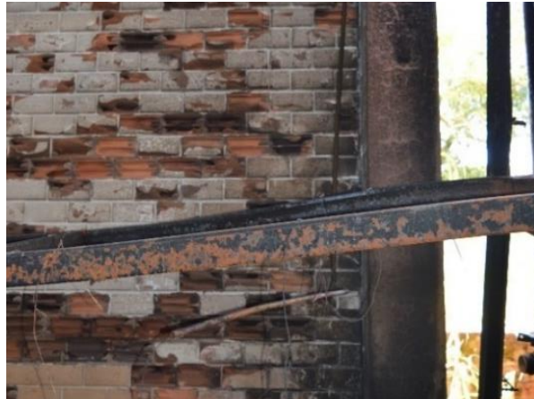
Figura 35 - Foco inicial do incêndio
