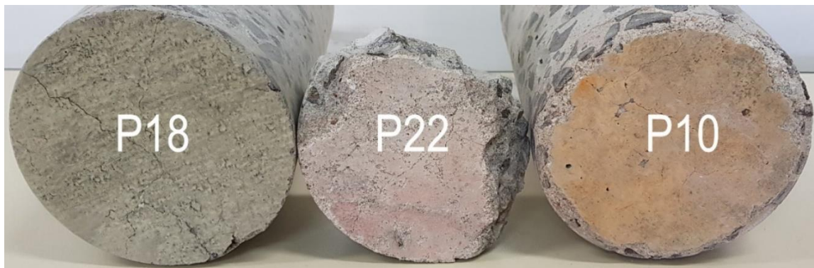
Figura 54 - Alteração de coloração superficial dos concretos de diferentes pilares
