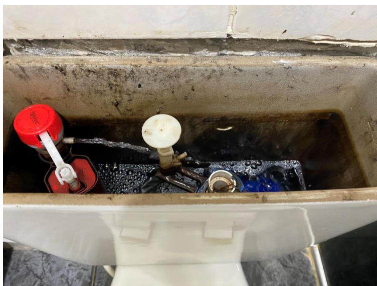
Figura 22 – Presença de precipitados avermelhados nos reservatórios internos.
