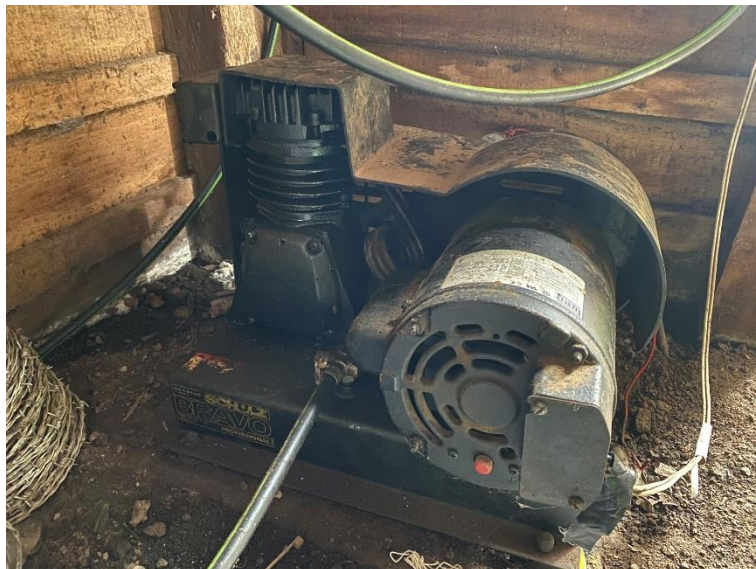
Figura 19 – Compressor de ar de pistão utilizado para o bombeamento de água para o reservatório.
