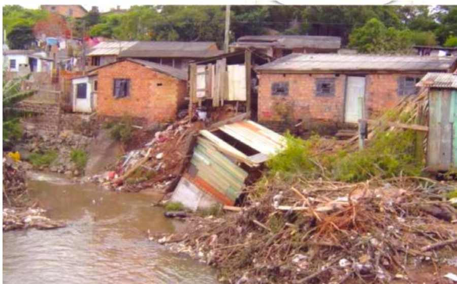
Figura 15: Ocupação de área de risco e de preservação ambiental no arroio Feijó, em Viamão.
