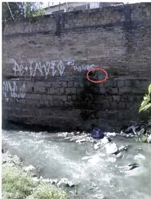
Figura 5.6 Lançamento de esgoto sanitário de um lote regular – trecho do Arroio à montante da ponte localizada na Rua Júpiter
