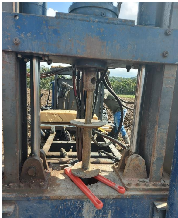
Figura 3.17 – Contato entre equipamento de cravação e haste, restringindo deslocamentos após aplicação de carregamento.
